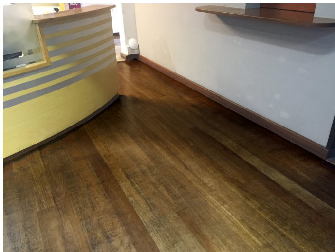
Plancher dans les locaux de Fibres Industries Bois - Saint Paul - La Réunion (France)
